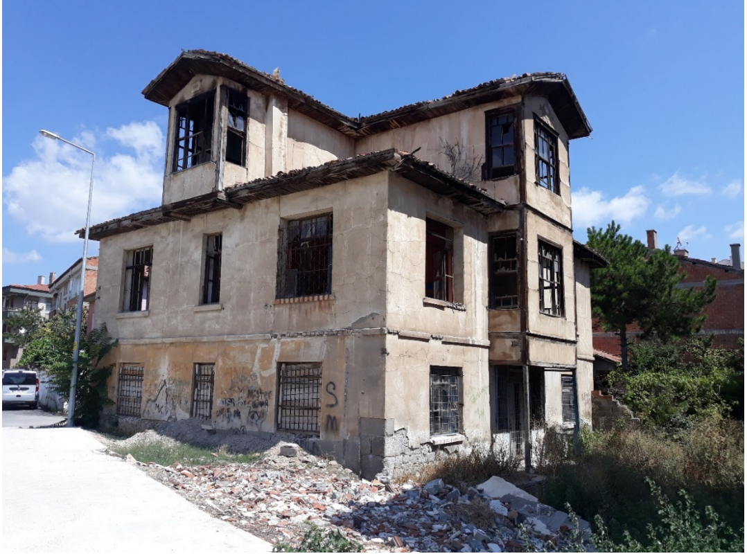
Foto 17: Üçtutlar Mahallesi'ndeki Bakımsız Geleneksel Bir Konut
