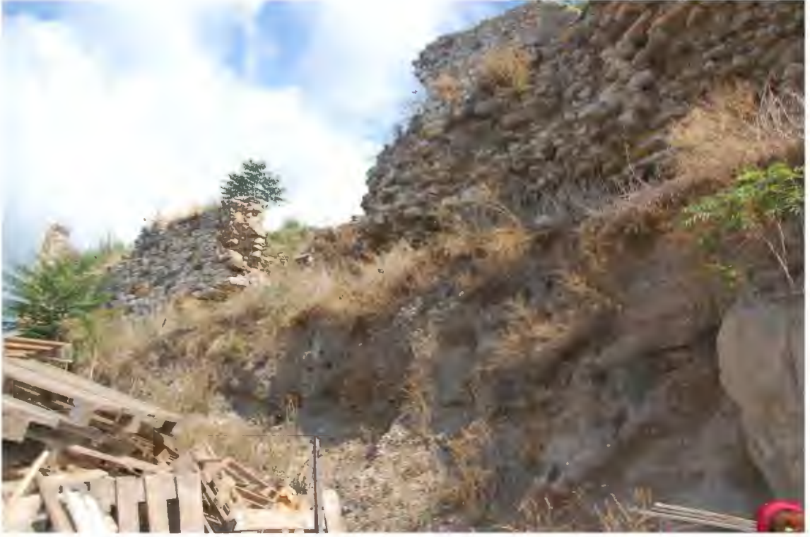
Res. 530. Surun alt kısmında görülen dolgu toprak (İ.H. Kurtuluş, 2018).
