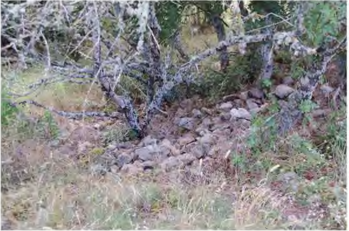
Res. 99. Ömeroba Kalesinin kuzeydoğu duvarının, yapının kuzey köşesine yakın yerde bulunan, dışa doğru akma yapmış taşları (İ.H. Kurtuluş, 2018).
