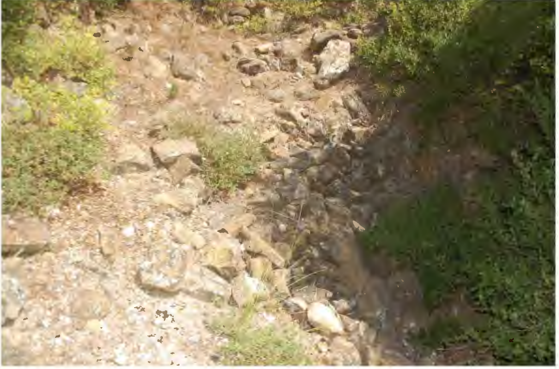
Res. 256. amlıca kalesinde bir duvardan dökülmüş taşlar (İ.H. Kurtuluş, 2018).
