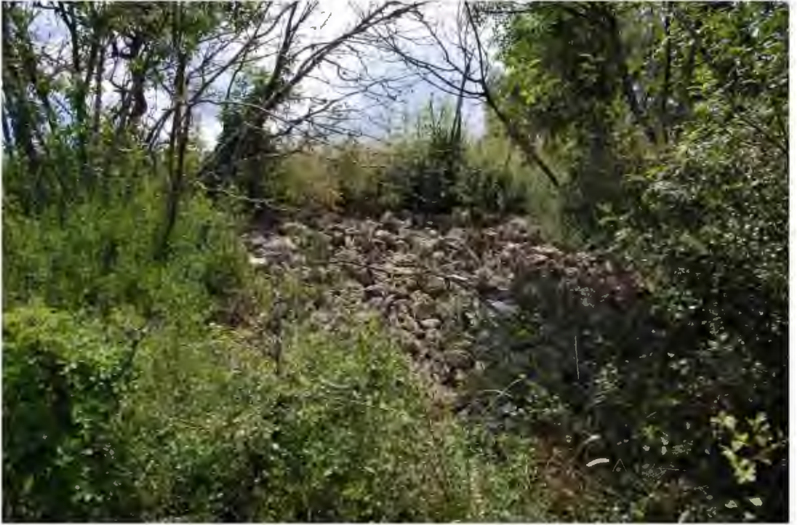
Res. 108. Kuzeybatı duvarından yıkılarak dökülmüş taşlar (İ.H. Kurtuluş, 2018).
