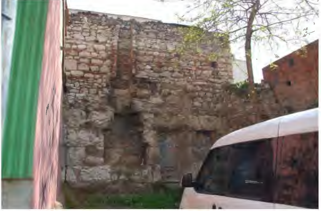
Res. 18. Mumcular sokaktan görülebilen 2 numaralı kuzey sur kalıntısının batıda kalan parçası. Sur kalıntısının kuzey cephesi (İ.H. Kurtuluş, 2019).
