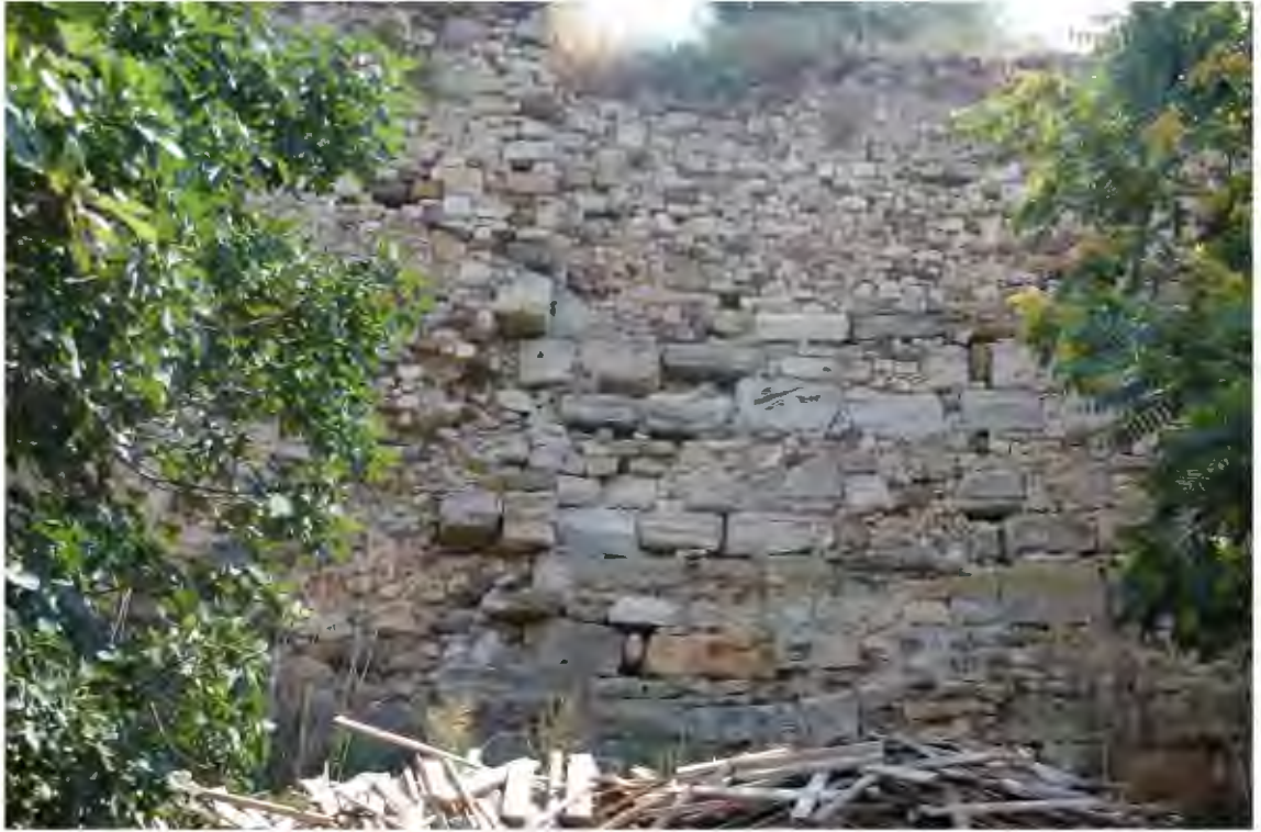
Res. 529. Enez Kalesinin batı surunda farklı taş malzemelerle yapılan onarım izi (İ.H. Kurtuluş, 2018).
