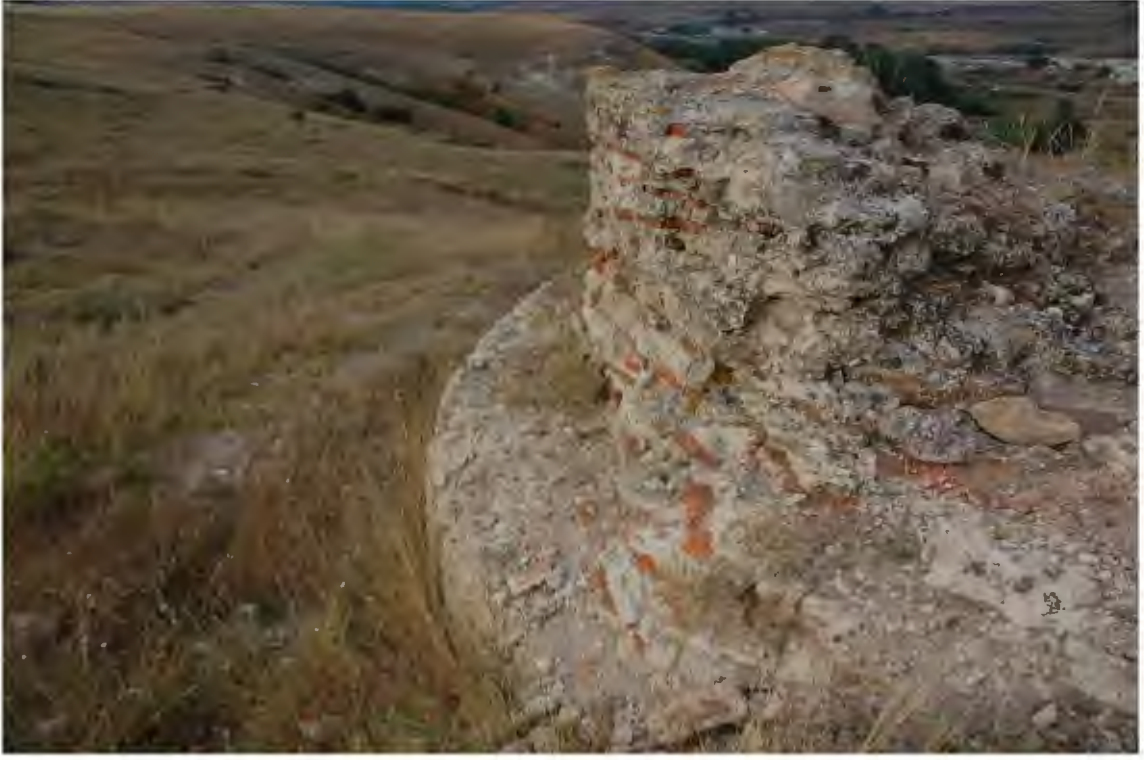
Res. 159. Kalenin güneybatı burcunda, aşağıdaki blok taş sırasının üzerindeki moloztaş duvarda görülen tahribat izleri (İ.H. Kurtuluş, 2018).
