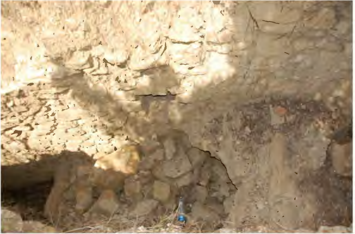
Res. 258. Galerinin doğu ucunda yıkılan tonozdan dökülen taşlar (İ.H. Kurtuluş, 2018).
