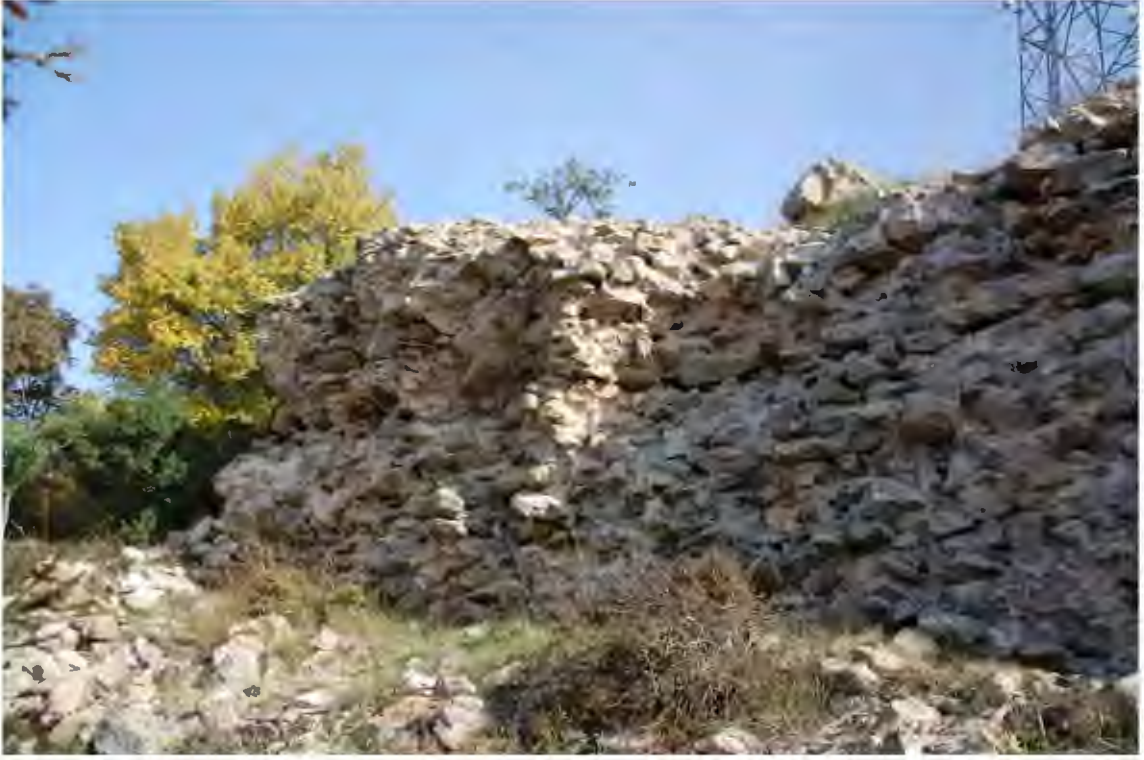
Res. 241. Batı duvarı ve dökülen taşlar (İ.H. Kurtuluş, 2019).
