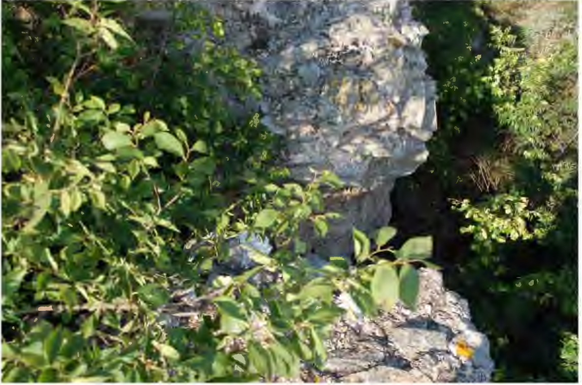
Res. 140. Köşeli U şeklindeki duvarın, burçla bağlantılı olan cephesindeki çatlak (İ.H. Kurtuluş, 2018).
