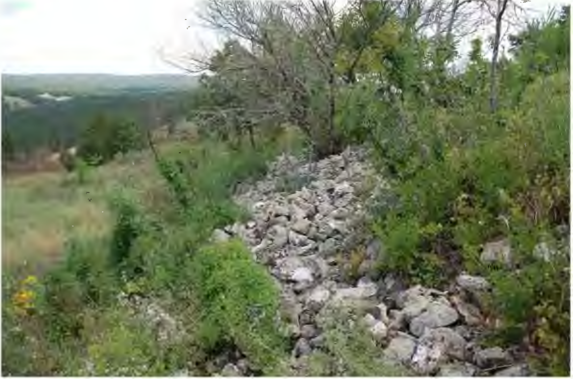
Res. 105. Kuzeybatı duvarının bir bölümünde dış araziye yıkılan taş kümesi (İ.H. Kurtuluş, 2018).
