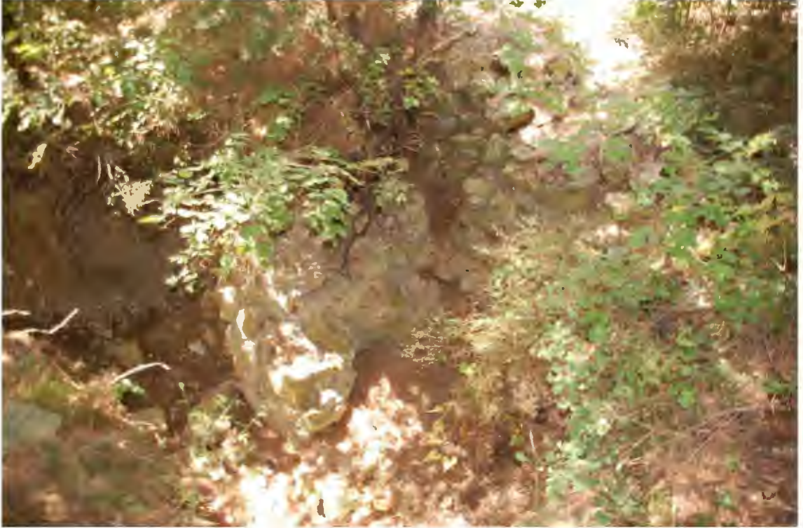
Res. 279. Dikdörtgen mekânın tahrip edilen yan duvarı (İ.H. Kurtuluř, 2018).
