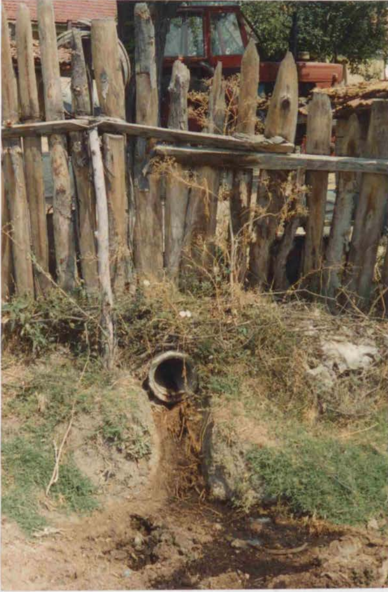
Ftr. 4 Açıkta Akan Kanalizasyon
