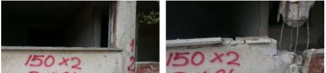
Şekil 4.13: 2.Deneme'de Atım Öncesi ve Sonrası Kolon Görüntüsü
