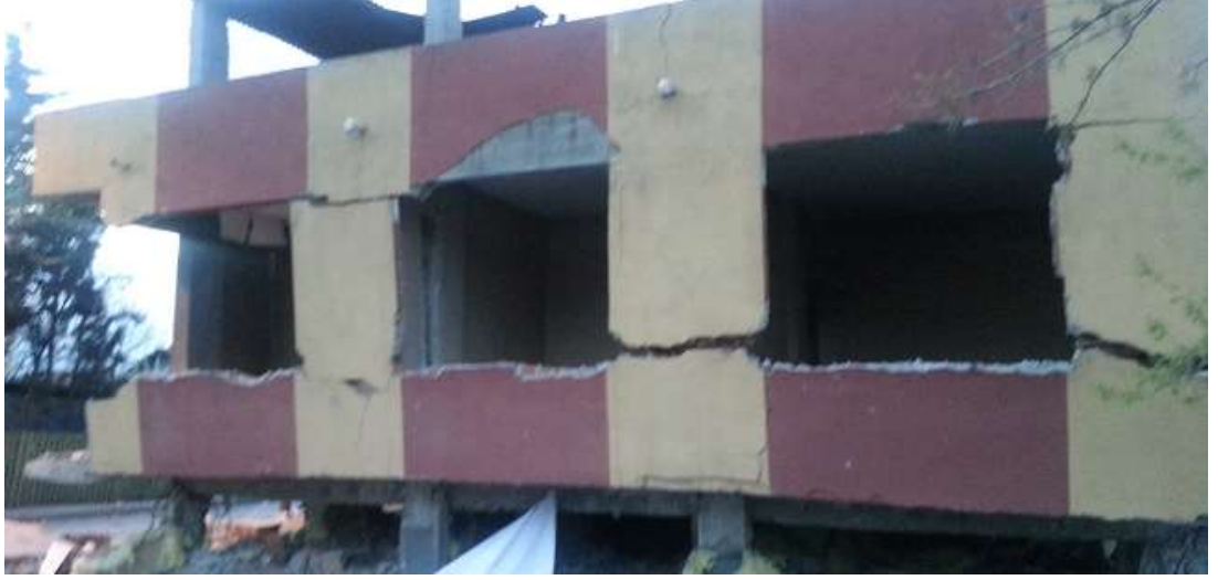
Şekil 4.47: Test Binasının Yıkım Sonrası Durumu
