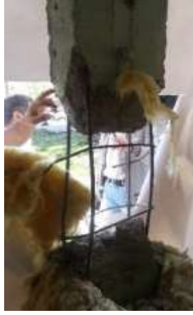
Şekil 4.42: 3 Numaralı Kolonun Ateşleme Sonrası Durumu
