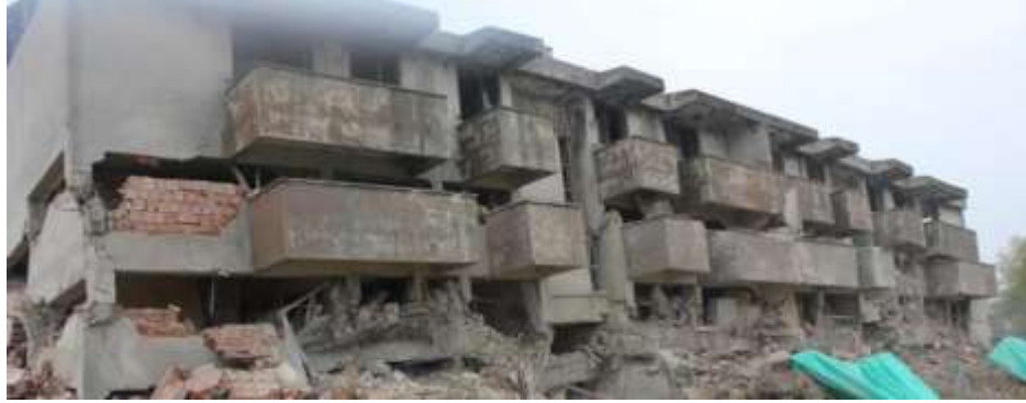
Şekil 4.25: Yıkılmış Binanın Görüntüsü
