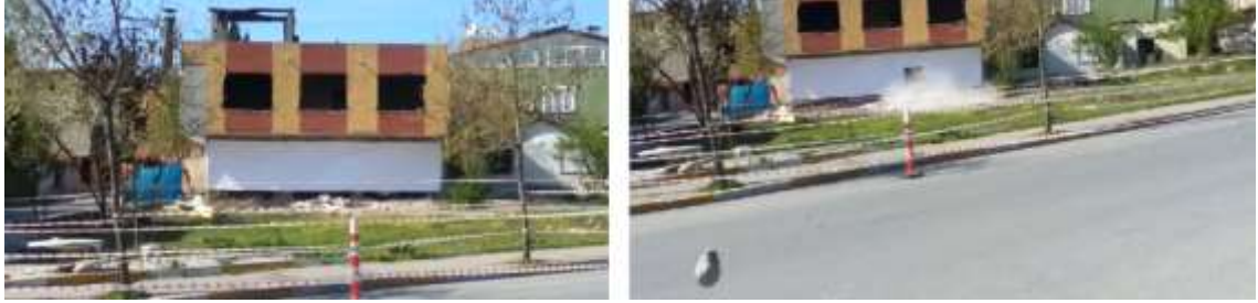
Şekil 4.43: 3 Numaralı Kolonun Ateşlenmesi Sonucu Parça Savrulması
