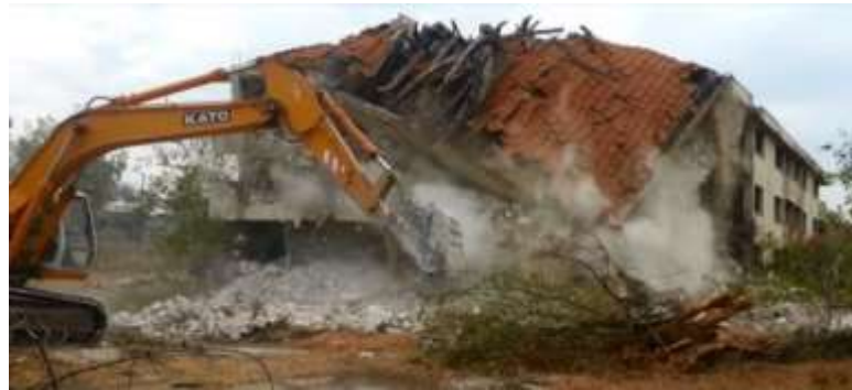
Şekil 4.35: Binanın Çökmesi Esnasında Bir Fotoğraf
