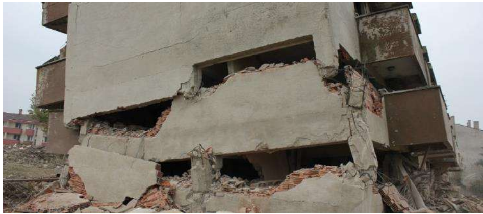
Şekil 4.26: Yıkılmış Binanın Görüntüsü
