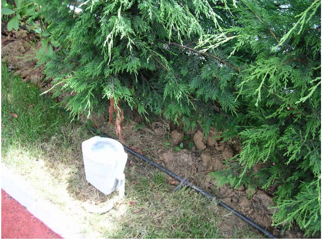
Şekil 3.20 : Bahçede kullanılan damlama sulama boruları ve aydınlatmalar.
