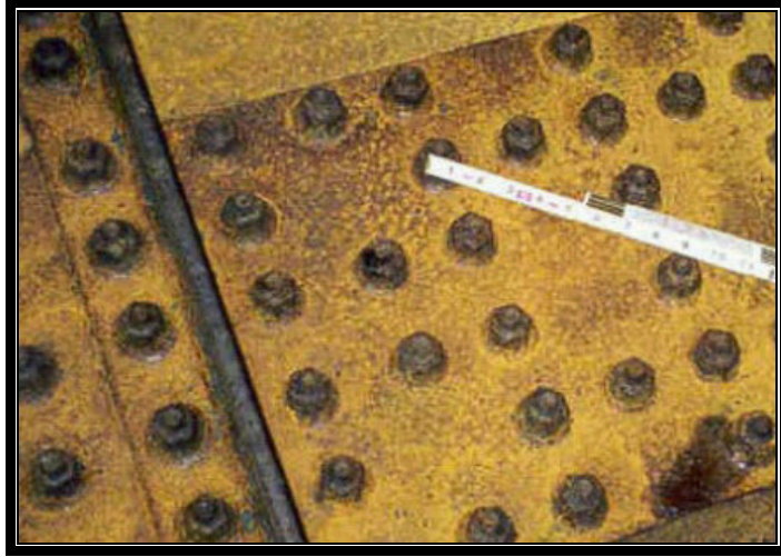
Şekil 3.16 Aktif korozyon başlangıcı ( Sarı-turuncu ) [20]
