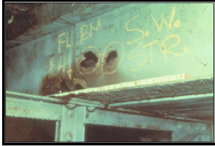
Şekil 3.14 Korozyon ve kesit kaybı [20]
