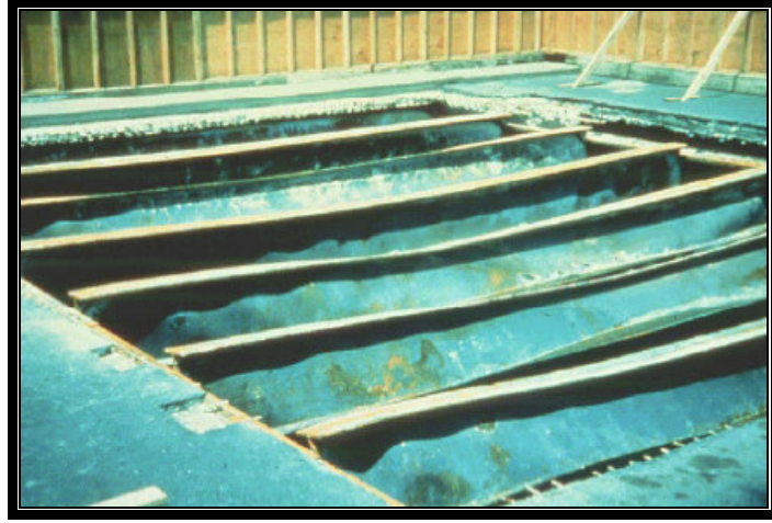
Şekil 3.21 Aşırı sıcaklık hasarları [20]
