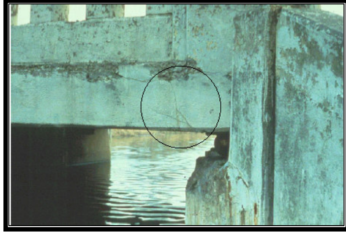
Şekil 3.5 Kesme çatlağı resmi [20]
