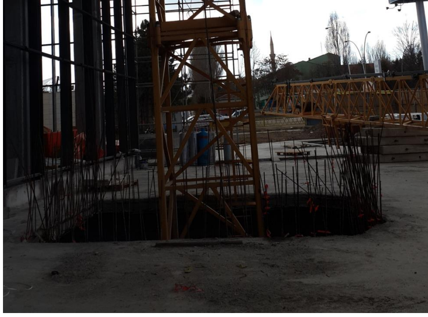
Şekil 46. Kule vinç boşluğu ve açıkta bırakılan demirler
