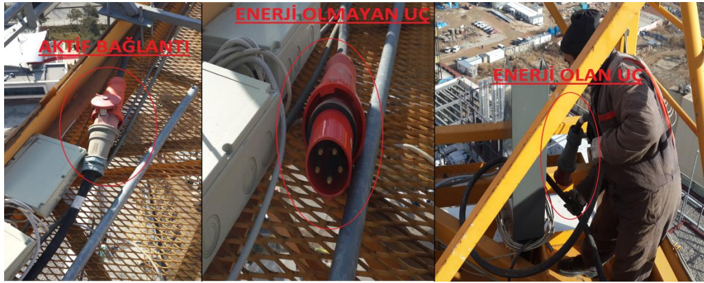
Şekil 49. Elektrik kaynaklı tehlikeler
