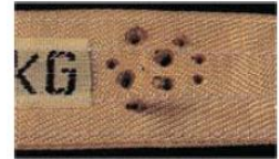
Aşırı sıcaklık nedeniyle hasarlanmış.
