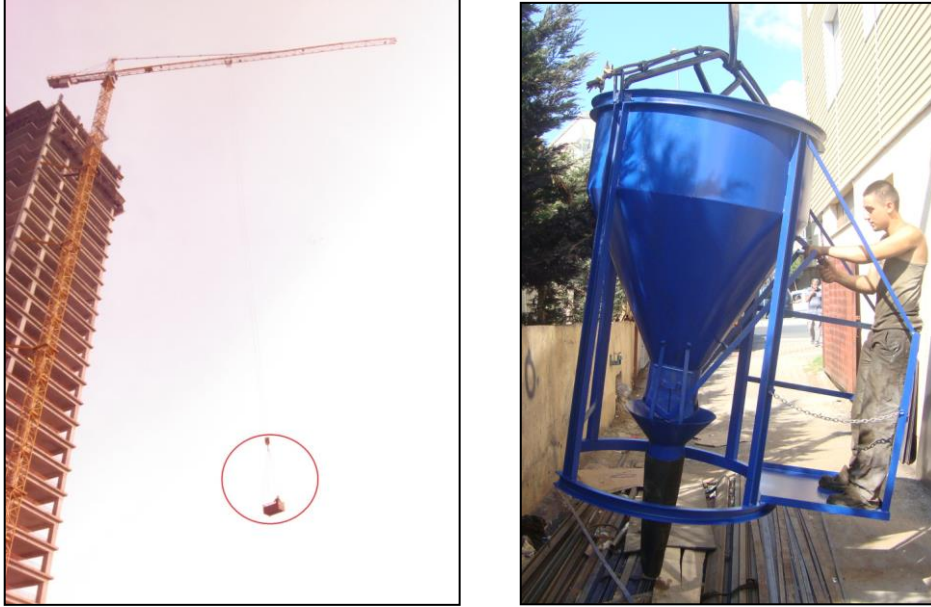
Şekil 39. Kule vinç sepetinde ve beton kovalarında insan taşınması
