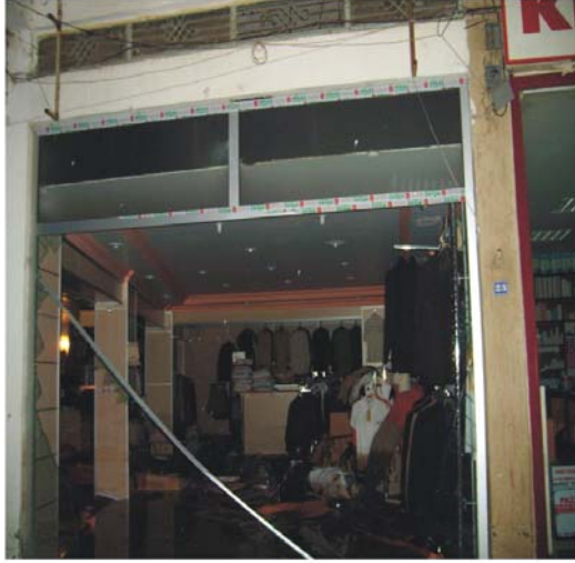
Foto :9 Fatsa şehir merkezi selden zarar gören işyerleri.
