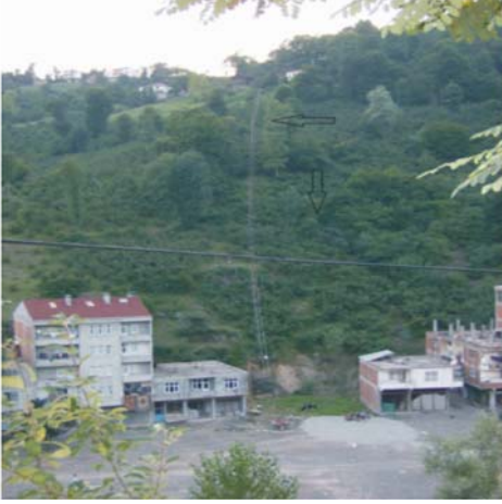
Foto:62 Kabataş'ın kuzeyi. Elektrik direklerinde crip'e bağlı çarpılma.
