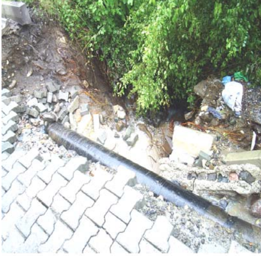
Foto :7 Dereüstü mahallesinde sağanak yağışla yolun bir bölümü küçük bir heyelanla tahrip olmuştur.
