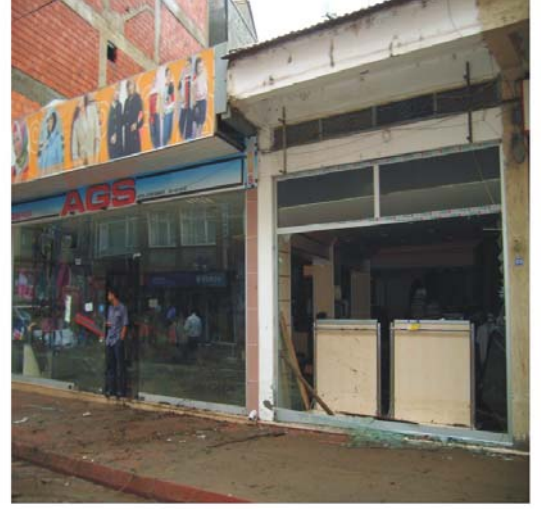
Foto :8 Fatsa şehir merkezinde selden zarar gören işyerleri.
