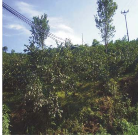
Foto:63 Korgan'ın güneyi crip'e bağlı telefon direklerinde meydana gelen çarpılma.
