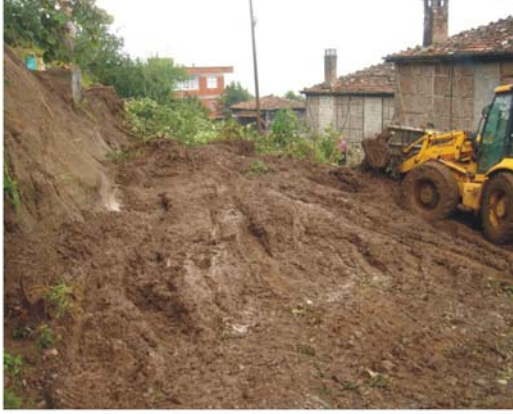
Foto :1 30.Haziran 2006'da sağanak yağışlar sonrasında oluşan sel ve sonrasında toprak yolların durumu (Aslan Cami- Fatsa).
