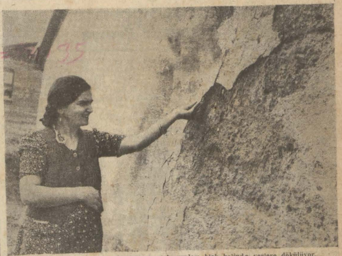
Elle dokunur dokunmaz, duvarların ıslak sıvaları blok halinde yerlere dökülüyor.
