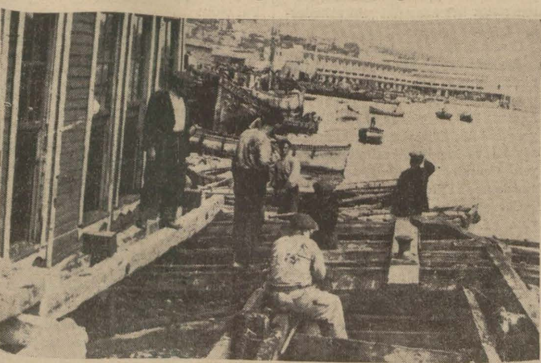
Haliçte Yemiş iskelesinin ayaklarının yerinden oynadığı görülmüş ve iskele-nin yeniden inşası kararlaştırılmıştır. Dünden itibaren bu işe başlanmıştır. Yukarıda eski iskele sökülürken görünüyor.
